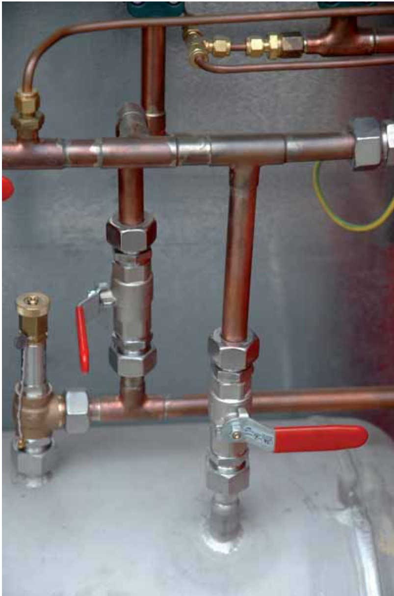
Bild: Gasleitungen aus Kupfer
