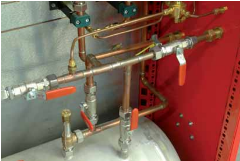
Bild: Bypass für Pufferbehälter, Ausblaseleitung
