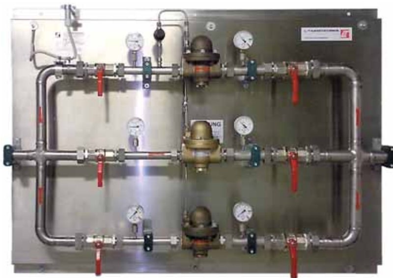
Bild: LTD-1-bestückte Druckregelstrecke Betriebsart B in Parallelschaltung
