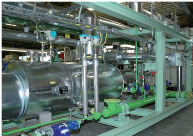
Abb.: Anlage auf Stahlträgergestell, Außenansicht
