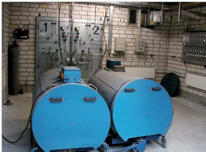
Abb.: Innenansicht des SO 2 -Versorgungsraums
