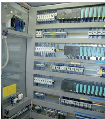
Abb.: Blick in den Steuer- und Regelungsschrank
