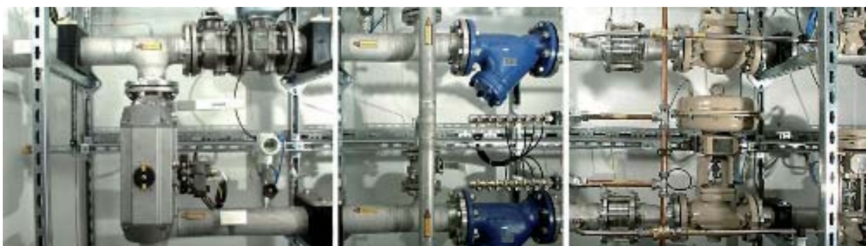
Abb.: Anlage im Container, Innenansicht
