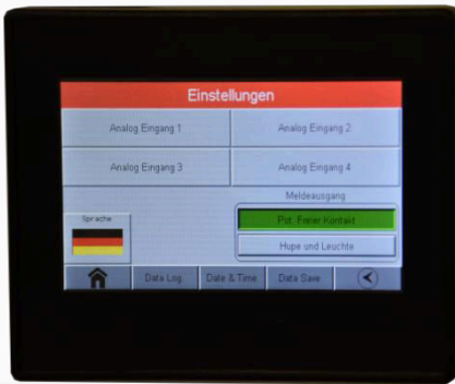
Benutzeroberfläche: Einstellungen Eingang, Ausgang, Sprache
