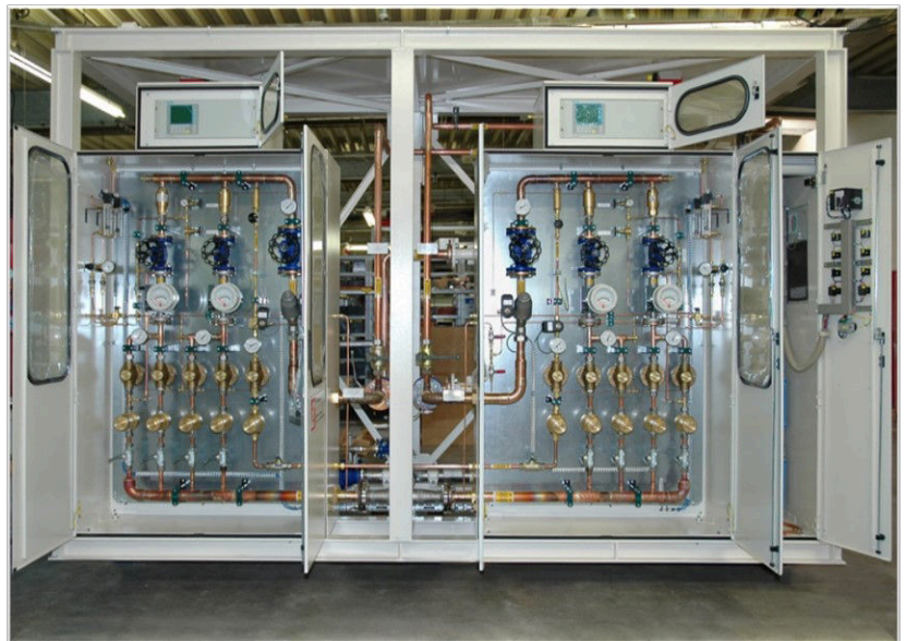
Redundante Gasmischer mit redundanter Gas-Analyse
