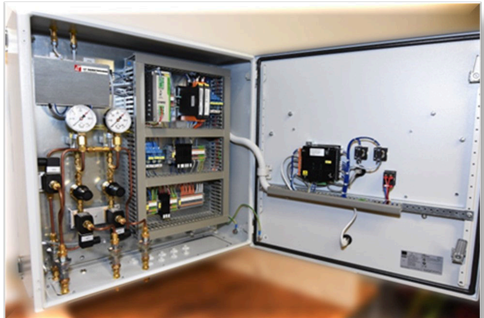
Analyseur de gaz LT redondant dans un boîtier mural avec commutation automatique du mélangeur de gaz et, étalonnage automatique du point zéro et du point final
